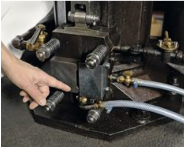
Tribut an die Sicherheit: Ein vorgesetztes Blech schützt die Pilotflamme des Atmosphärischen Gasmotors. Erkennbar ist der »Eingriff« an den modernen Schrauben.
