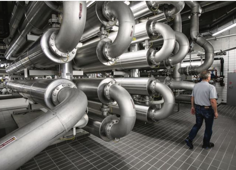
Bild links: Im »Wärmetauscher« wird der Schlamm für die Faulbehälter erwärmt.
