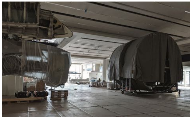
19 Dauerausstellungen und 2 Sciencelabs sollen bis 2022 fertiggestellt werden. Hüllen schützen die Objekte vor Baustaub.
