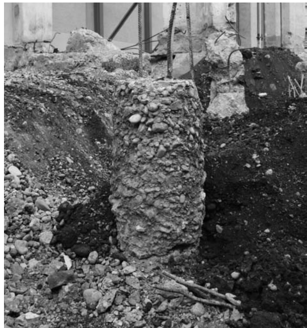
Zustand eines freigelegten alten Bohrpfahls (Oktober 2009).
